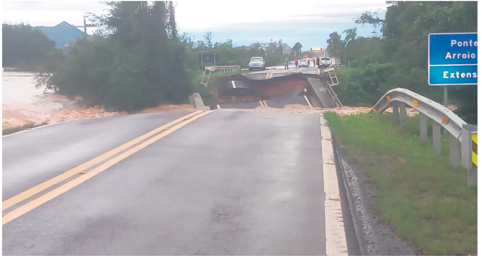
QUEDA DE PONTE Estrutura de 36 metros sobre o Arroio Grande, na RSC-287, entre a Vila Fighera e o acesso a Silveira, foi arrastada pelas águas
